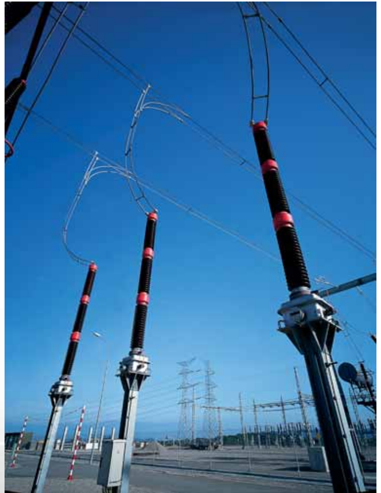
Transformadores de Tensión Capacitivos de 400 kV. Red Eléctrica Española (España).
