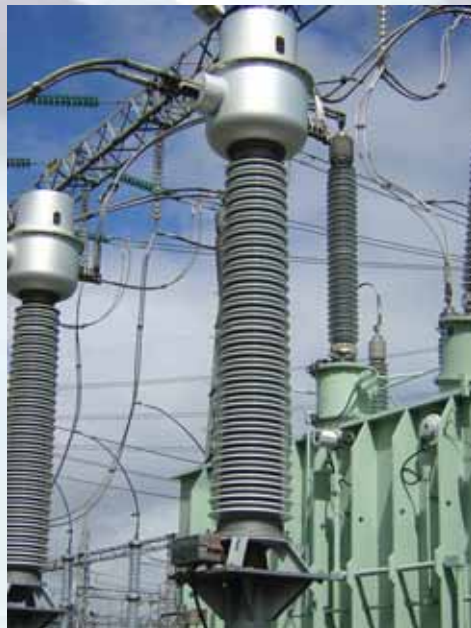
Transformadores de Intensidad de 245 kV con diseño especial antisísmico. Transpower (Nueva Zelanda).
