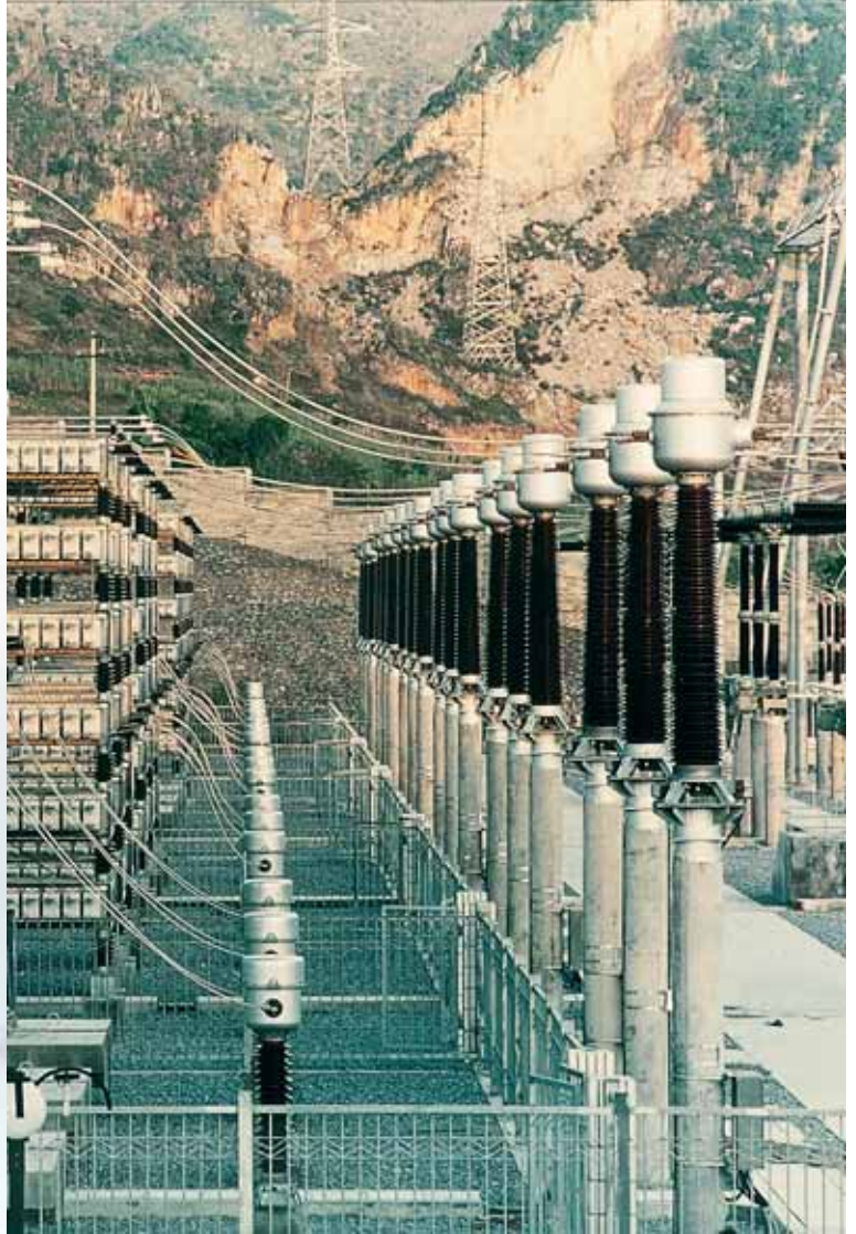
Transformadores de Intensidad de 245 y 123 kV en interconexión de corriente continua (H.V.D.C.). Diseñada por Siemens Alemania para State Power South Co. (China).
