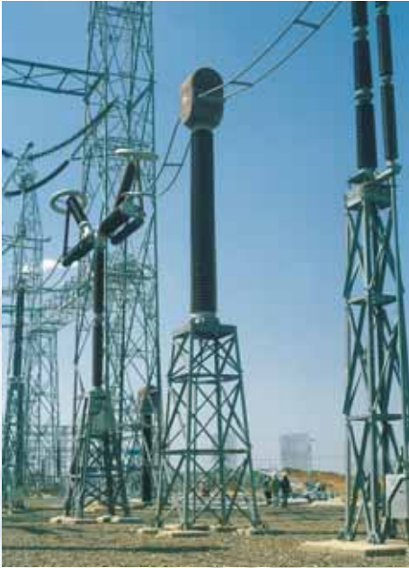
Transformadores de Intensidad de 525 kV instalados en 1980 en la interconexión energética entre Argentina y Brasil.
