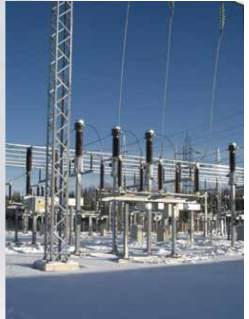
Transformadores de Intensidad de 123 kV. Eesti Energia (Estonia).
