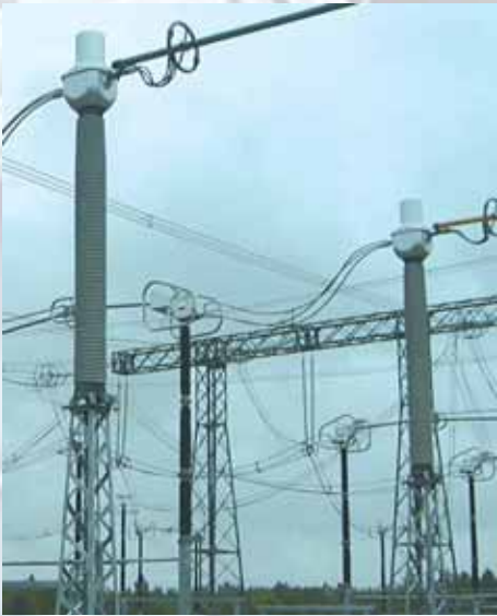
Transformadores de Intensidad de 765 kV. Leningradskaya (Rusia); cerca de la frontera con Finlandia.
