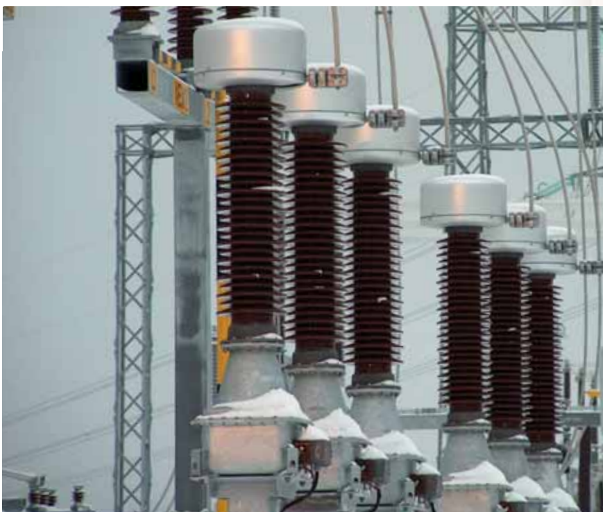
Transformadores de Tensión Inductivos de 123 kV. Fingrid (Finlandia).
