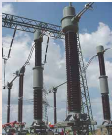
Transformadores de Intensidad y de Tensión Inductivos de 420 kV en entrada de línea de subestación Vattenfall Transmission (Alemania).
