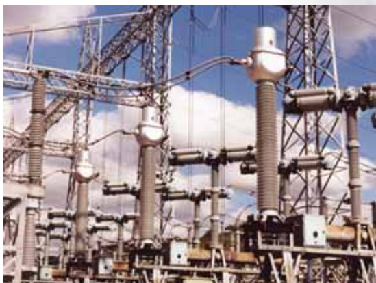
Transformadores de Intensidad de 362 kV de medida y protección. Louisville Gas & Electric (USA).
