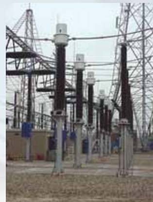
Transformadores de Intensidad de 420 kV en entrada de bancos de condensadores. Tennet (Holanda).
