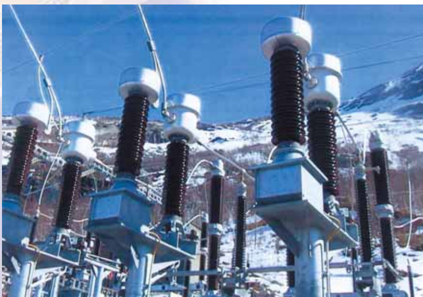
Transformadores de Intensidad y de Tensión Inductivos de 145 kV en condiciones climáticas extremas. Salten Kraftsamband (Noruega).
