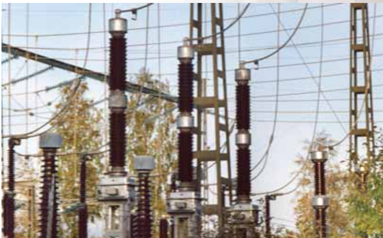
Transformadores de Tensión Capacitivos de 245 kV. Svenska Kraftnät (Suecia).
